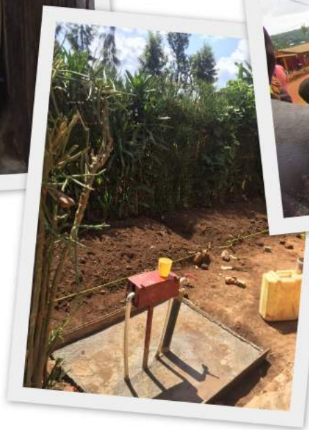
Neu installierte Wasserversorgung
